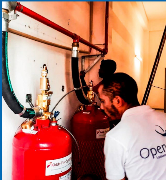
SEGURANÇA CONTRA INCÊNDIOS
